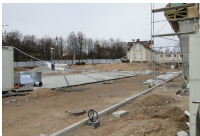
Parkingi będą wybrukowane kostką granitową. Na zdjęciu prace przy budowie parkingów i tras pieszych.
