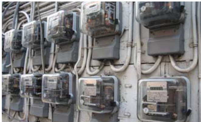
Liczniki na zewnątrz budynku
